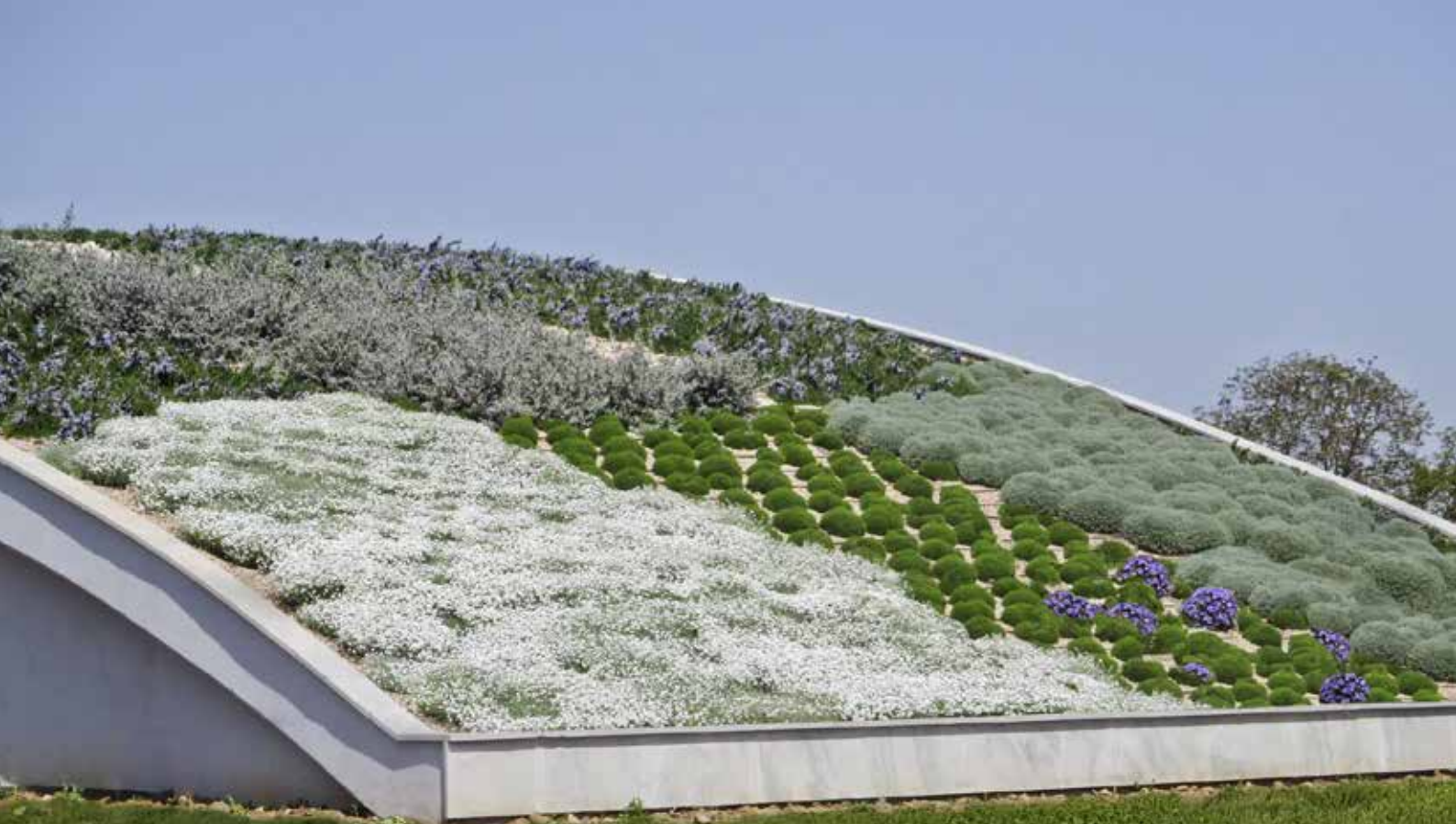
Foto arriba: Espectacular cubierta verde con pendientes variables de hasta 45. Sistema ZinCo Georaster, perimetral del alero.
